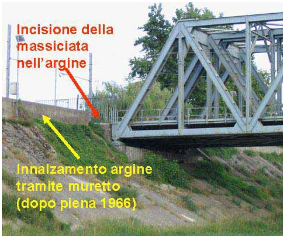
Figura 15: Il ponte ferroviario della linea Venezia-Trieste presso Latisana . Si nota come la struttura risulti incassata nell'argine, causando un'incisione nel muretto di protezione.
